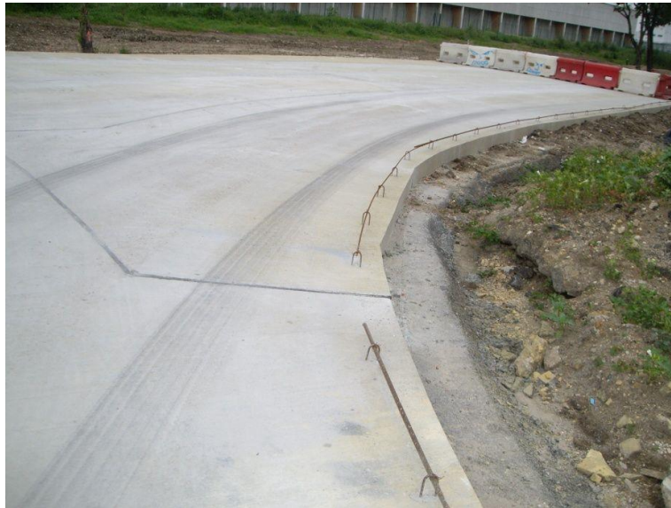
Photo 9 : Attente pour bordure en béton coulé en place (Crédit photo : CMR Exedra)
