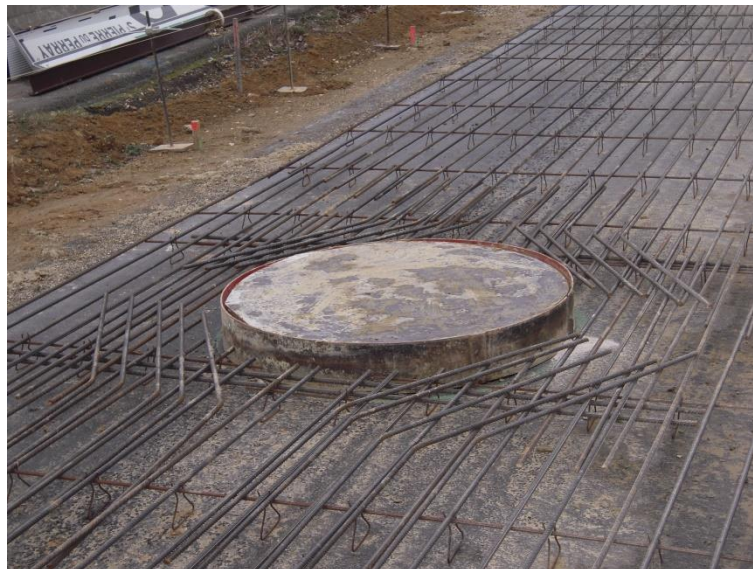
Photo 10 : Dispositif assurant la continuité des armatures autour d'un regard (Crédit photo : J. ABDO)
