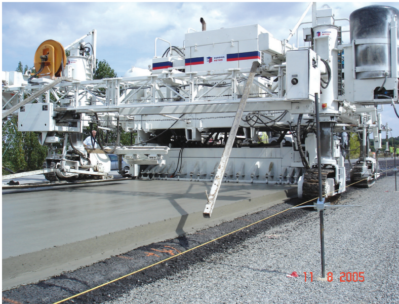
Mise en œuvre du béton armé continu à l'aide d'une machine à coffrage glissant sur une fondation en grave bitume.
